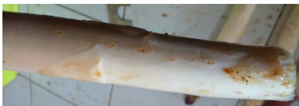
Dégâts de myriapodes
